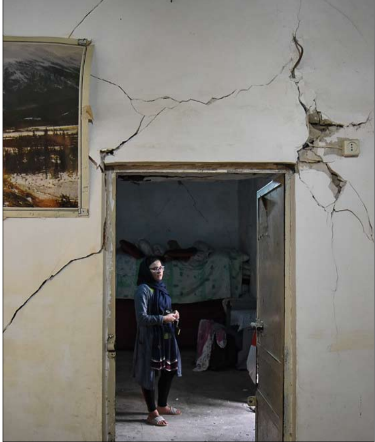
خسارت‌های زلزله مسجد سلیمان / منبع: باشگاه خبرنگاران
