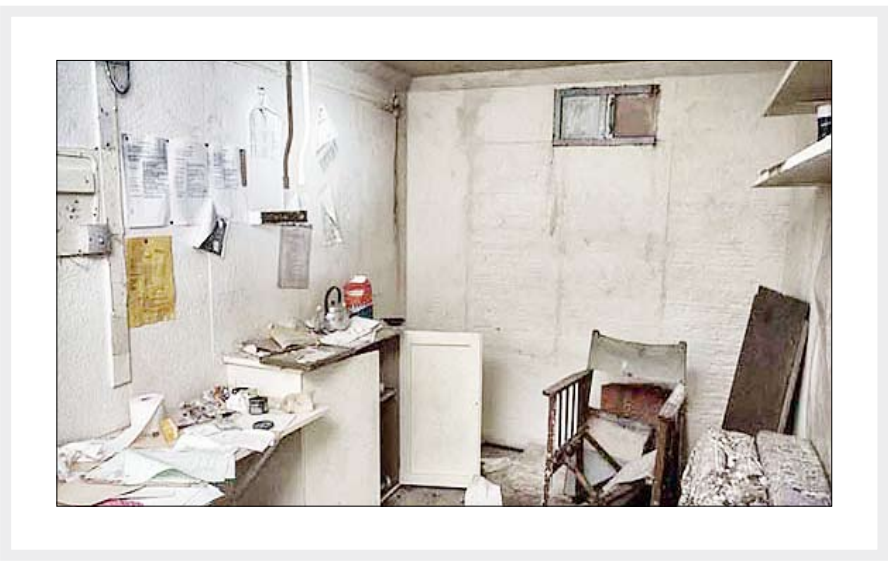
تخریب‌های گسترده در ساختمان‌های مسکونی در تهران، که به دلیل کمبودهای اساسی در مقررات ملی ساختمان و عدم رعایت استانداردهای ایمنی، منجر به خسارت‌های جبران‌ناپذیر شده است.
